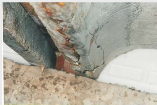
Beschadigd prefab element
