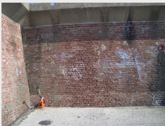
Detail schade "Keijzersbolwerk"
