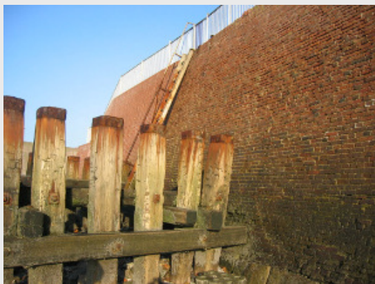
Schade "Muur van Altena"
